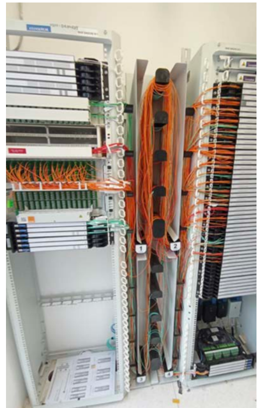
Armoire colocalisée dans laquelle le technicien doit venir faire le jarretière.
